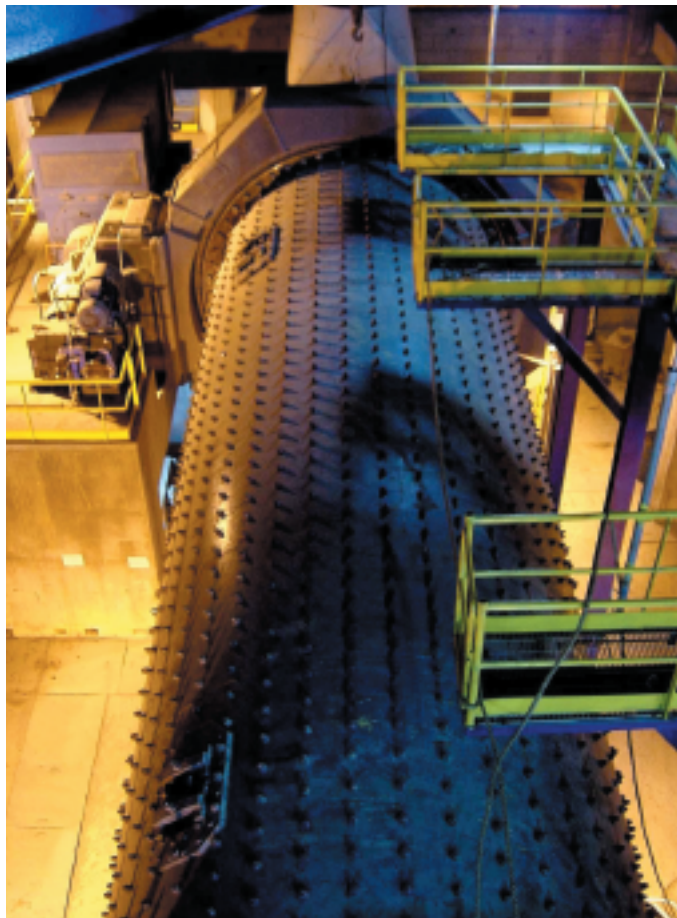
Abb.9: Rohrmühle mit DMG2
